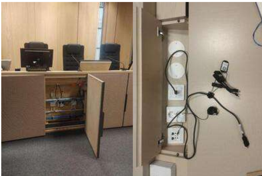
Figura 24. (Da esq. para a dir.) Detalhe da cablagem oculta nos painéis de mesa e das tomadas de encastrar nas mesas das salas de audiências do Tribunal Judicial de Malmö
